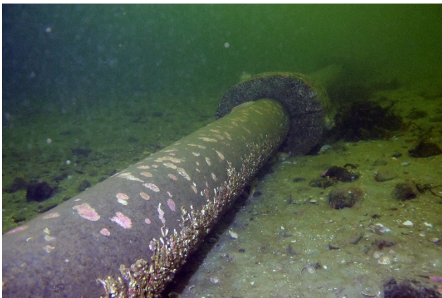
Figur 4-9. Avløpsrør som følget dykketransektet.
